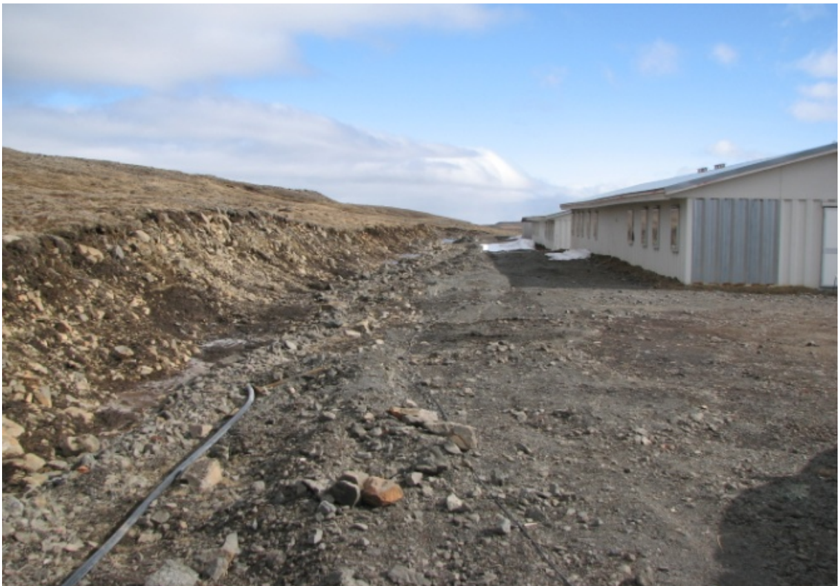
Mörk efri (NV) jaðars búðasvæðis og óhreyfðs lands ofan vinnubúða. Áður en frágangur hófst voru steypar undirstöður og allar lagnir fjarlægðar. Við frágang þessa svæðis var reynt að móta svæðið að mestu leyti með því efni sem fyrir var í malarpúðum undir vinnubúðum. (10.05.2007)
