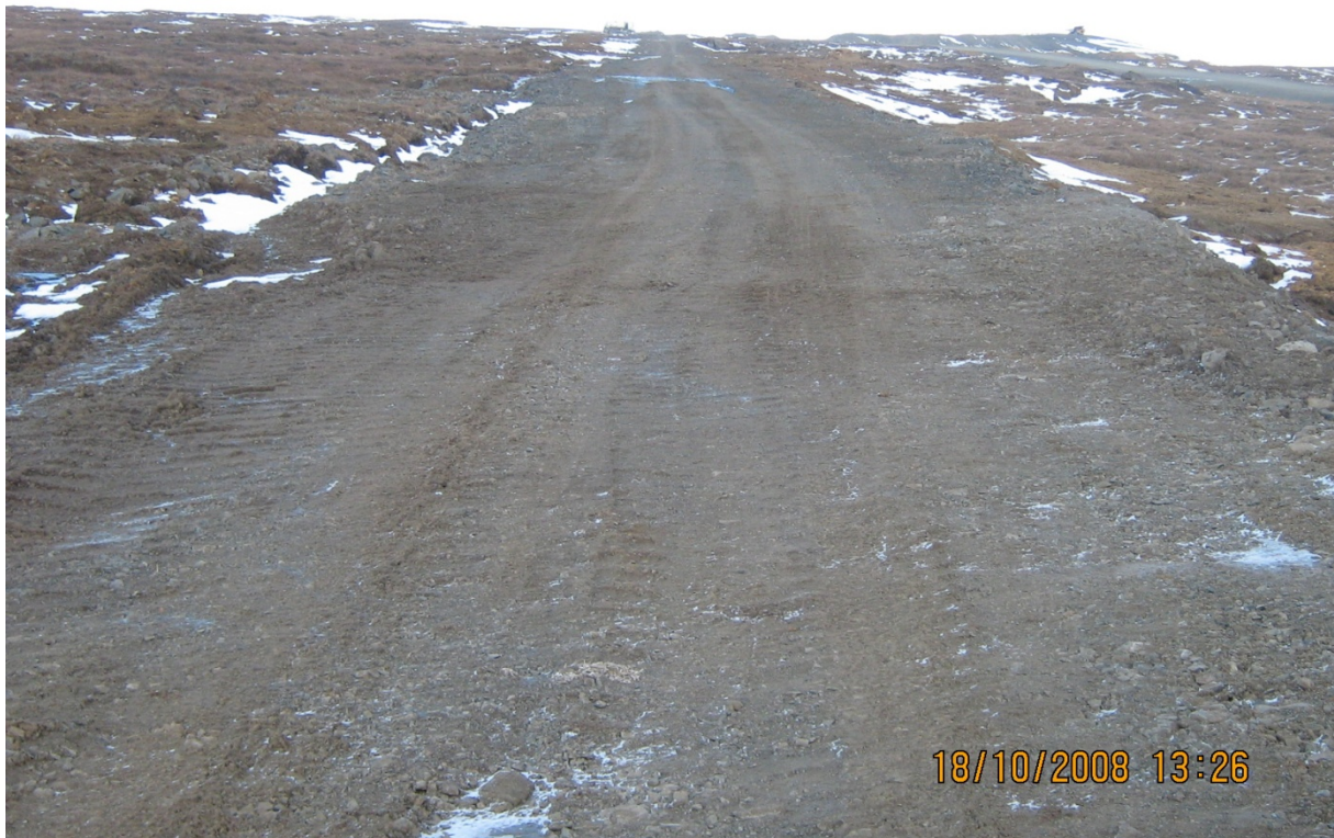
Vegur að haugsvæði. Talsvert úrrennsli var úr veginum auk þess var hann talinn of stór til að unnt væri að fella hann vel að landi. Efni úr veginum var því flutt á haugsvæði og gerðar vatnrásir í gegnum veginn til að draga úr rofi. (18.10.2008)
