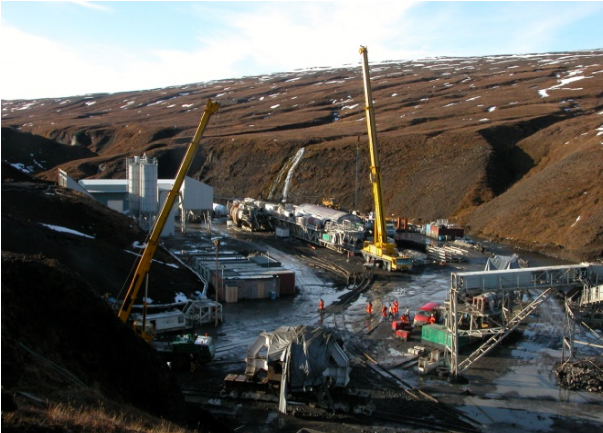
Borun jarðganga lokið. Byrjað er að taka niður færiband. Búið er að taka jarðgangabor í sundur og flytja hann út úr göngunum. Hluti plans var steyptur til að bera þung tæki eins og borinn. (10. 2005)
