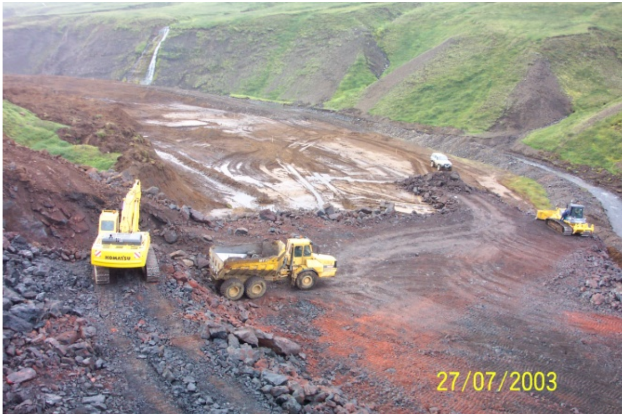
Undirbúningur framkvæmda. Efni í planið kom að hluta úr efni sem mokað var frá gangnamunnum. (27.07.2003)
