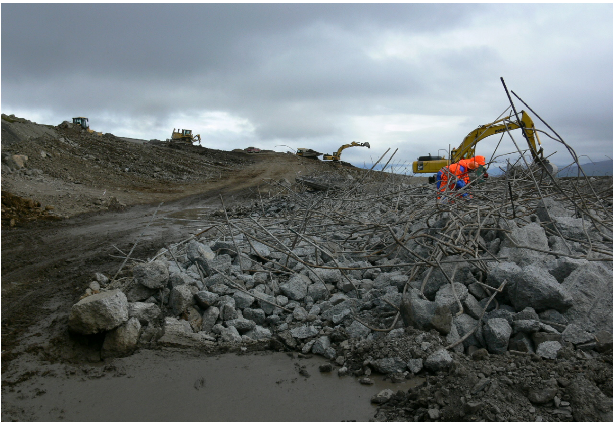
Jarðgangaborinn var settur saman utan við gangnamunnan. Steypa þurfti plötu undir borinn meðan á samsetningu stóð. Steypa var urðuð á haugsvæði, en járn flutt til endurvinnslu. Verið er að grófmóta brekku og færa veg ofar um athafnasvæðið. Horft til norðurs.
