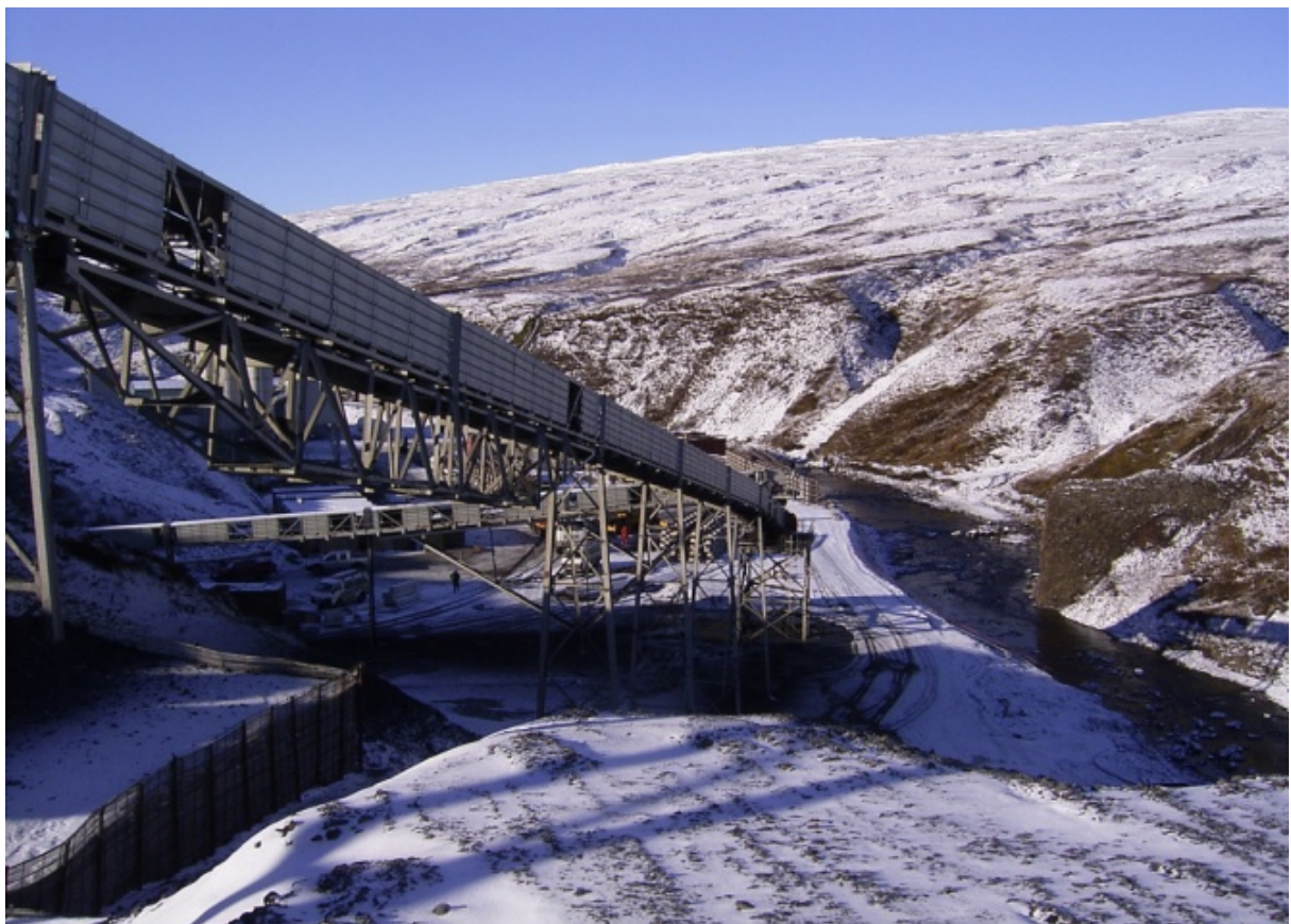
Aðstaða verktaka við aðkomugöng III. Fremst á myndinni er færiband sem flutti efni úr jarðgöngunum á haugsvæði. Í bakgrunni sést steypustöð og verkstæði. (07.10.2004)
