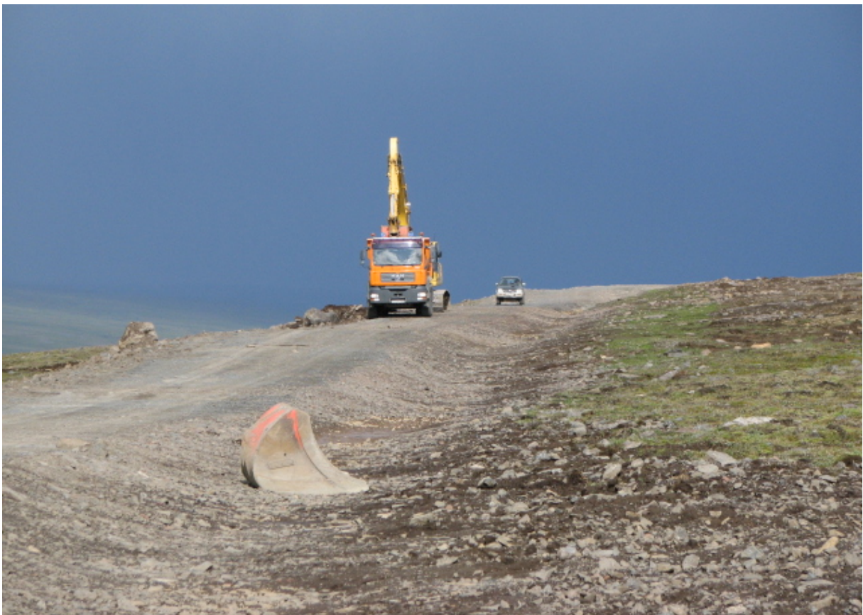
Vegur að sveiflugöngum. Umframefni, sem ekki var unnt að koma fyrir á ásættanlegan hátt við veginn, var mokað á vörubíl og fjarlæggt. (13.08.2009)
