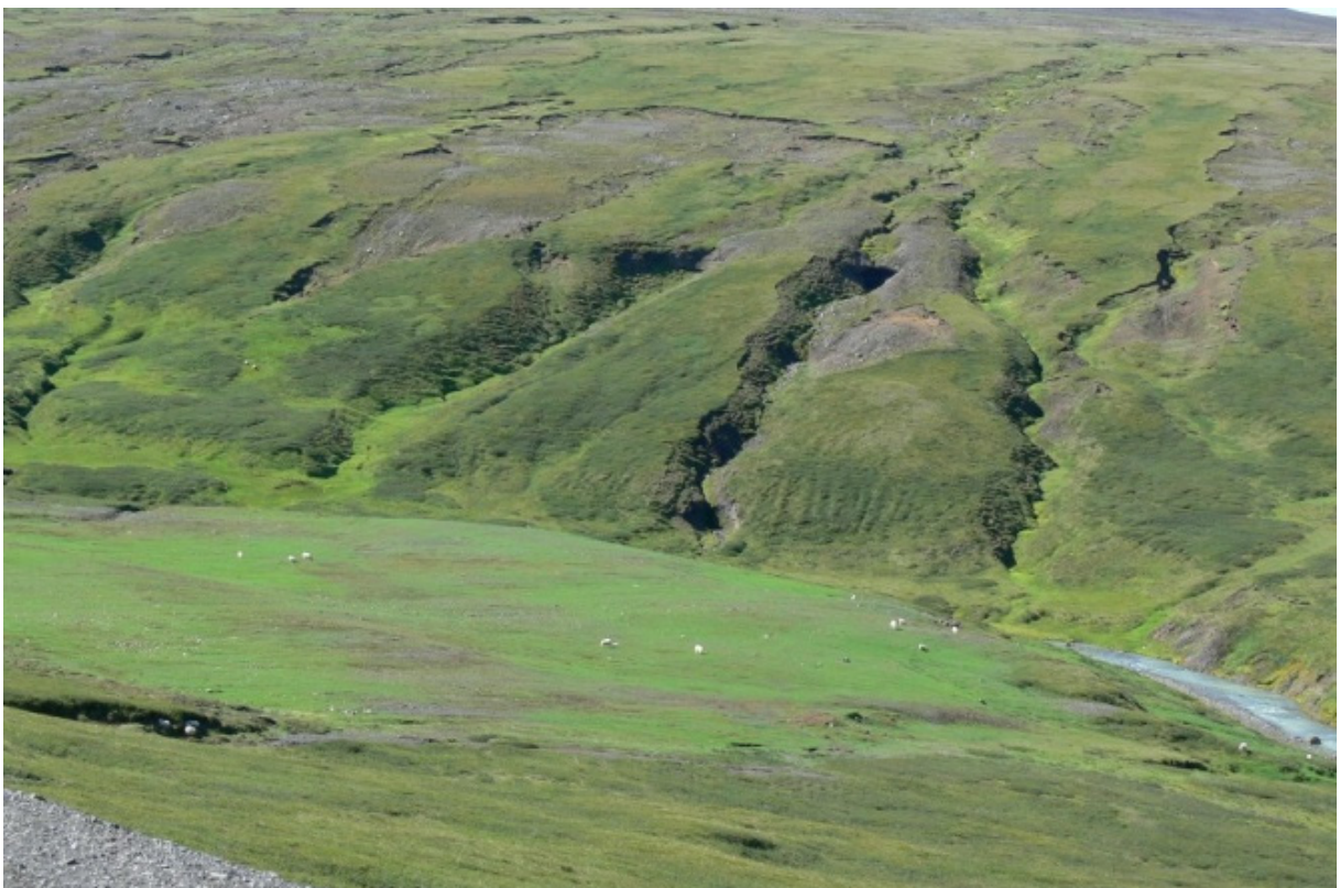
Frágangi búðasvæðis lokið. Áður en svæðið var mótað voru allar steypur undirstöður sem og allar lagnir fjarlægðar. (19.07.2010)
