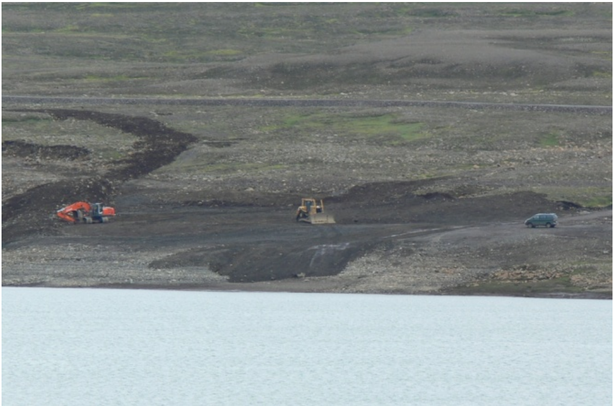
Landmótun á aðstöðusvæði að ljúka. Unnt var að koma miklu efni fyrir við bakka ofan við plan. Grafan til vinstri á myndinni hefur lokið við frágang á skurði sem í var háspennustrengur sem var fjarlægður. (10.07.2010)
