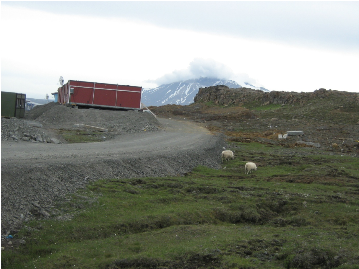
Efsti hluti búðasvæðis. Allar lagnir voru fjarlægðar. Leitast var við að móta samfelld aflíðandi svæði frá klettum niður í gegnum búðasvæðið. Fremur lítil ofafnafýting var við búðasvæðið. Mold var grafinn upp til frágangs áður en mölinni var jafnað út. (20.06.2008)
