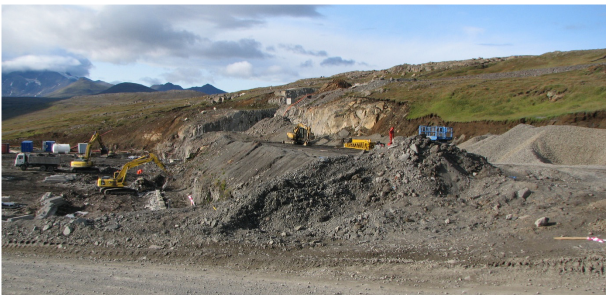
Athafnasvæði Impregilo við aðgöng II, efri hluti svæðis. Vegur færður ofar á athafnasvæði. Flytja þurfti að efni og jarðveg til að móta samfellda brekku frá vegi um efri stall að óraskaðri brekku ofan athafnasvæðis. (15.09.2008)
