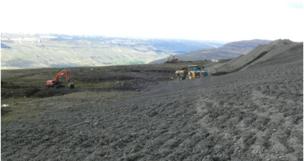
Jarðvegur var fjarlægður af haugsvæði við upphaf framkvæmda og geymdur til frágangs að framkvæmdum loknum. Þegar mótun haugsins var lokið var jarðvegur fluttur upp á haugsvæðið. (21.06.2009)
